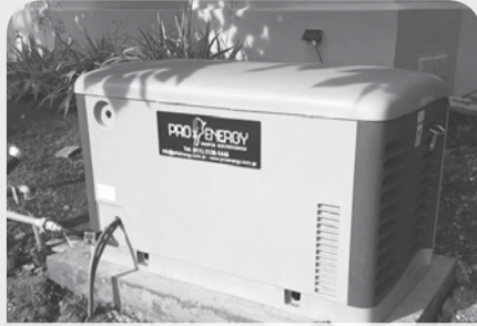
Grupo electrógeno de 15 kva, a gas, instalado en Saint Thomas.
