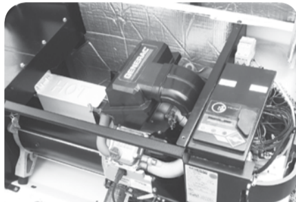
Grupo electrógeno instalado en Solar del Bosque.
